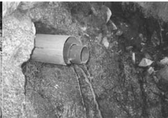
Foto 12 - Exemplo de má captação horizontal
