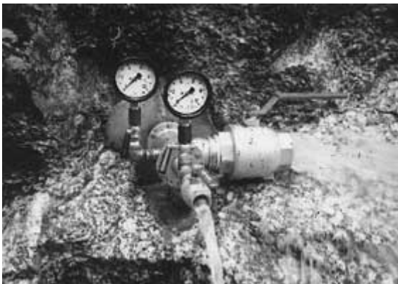
Foto 11 - Cabeça da captação dupla - Furo Horizontal
