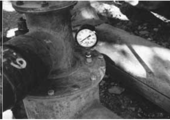
Foto 8 - Indicador de pressão no espaço anular
